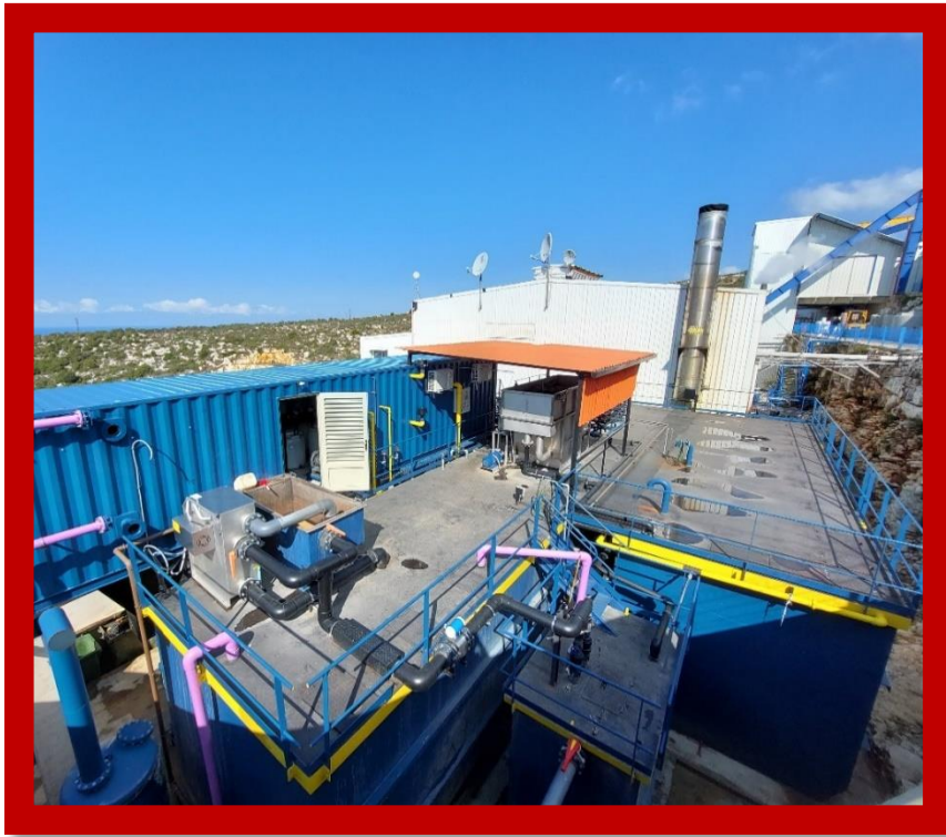
محطة معالجة مياه الصرف الصحي الصناعي في معمل قرطاس – شباط 2023
