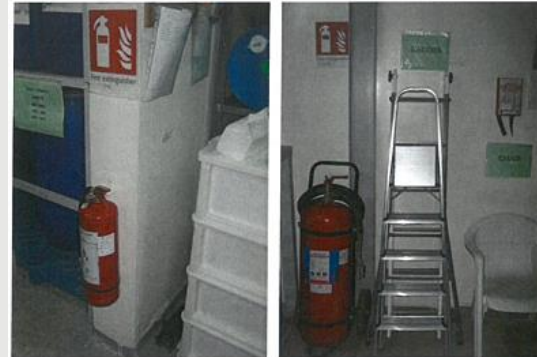
الرسم ١٢،١١- طفايات الحريق والبطانيات صُنفت بشكل واضح ويمكن الوصول إليها بسهولة Beesline
